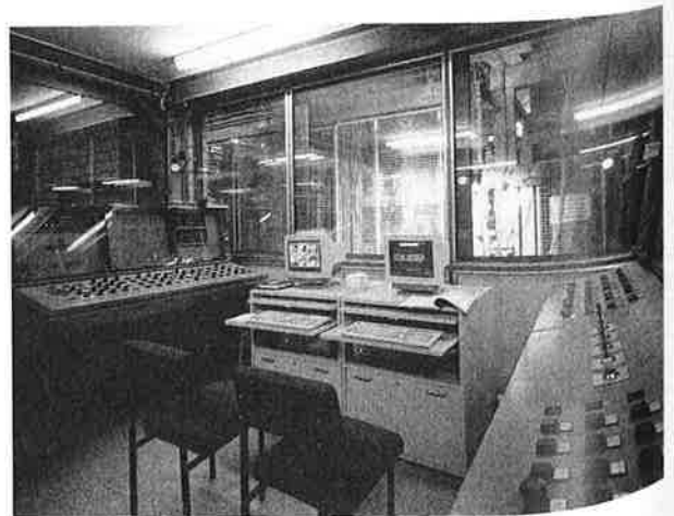
Bild 7. Steuerkabine Fig. 7. Control cabin Fig. 7. Cabine de commande
